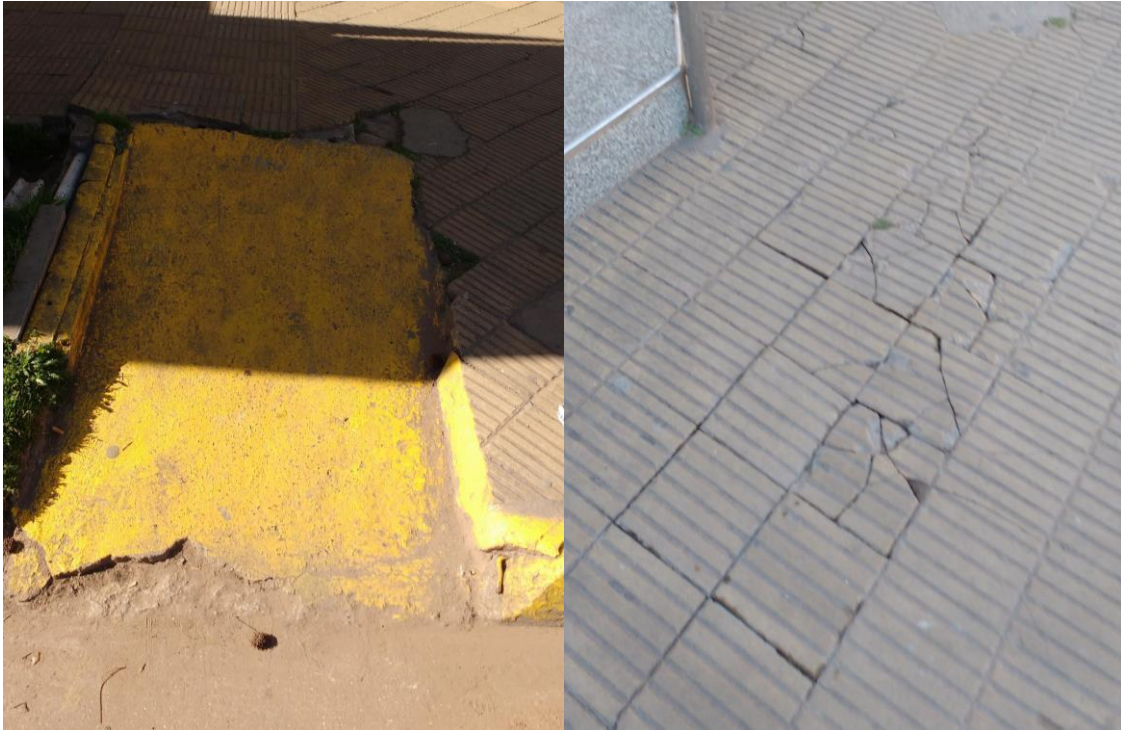
Rampa desde la calle del Banco Nación y el estado de sus veredas.
